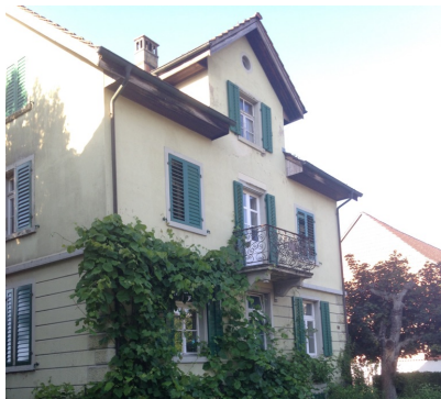
Beispiel eines bestehenden Balkons, der über den traufseitigen Dachvorsprung ragt und daher heute baurechtswidrig ist.
