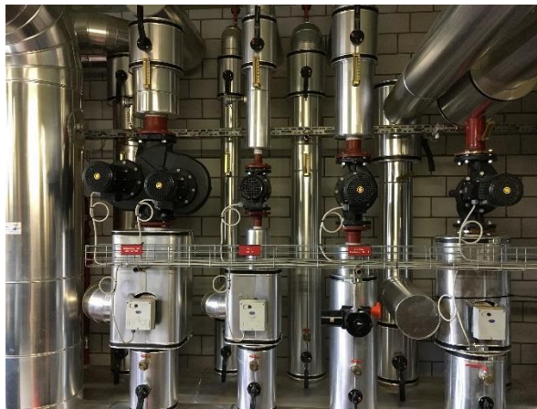
Abbildung 1: Gärtnerei Meier AG, Wärmeverteilbalken in Heizzentrale
