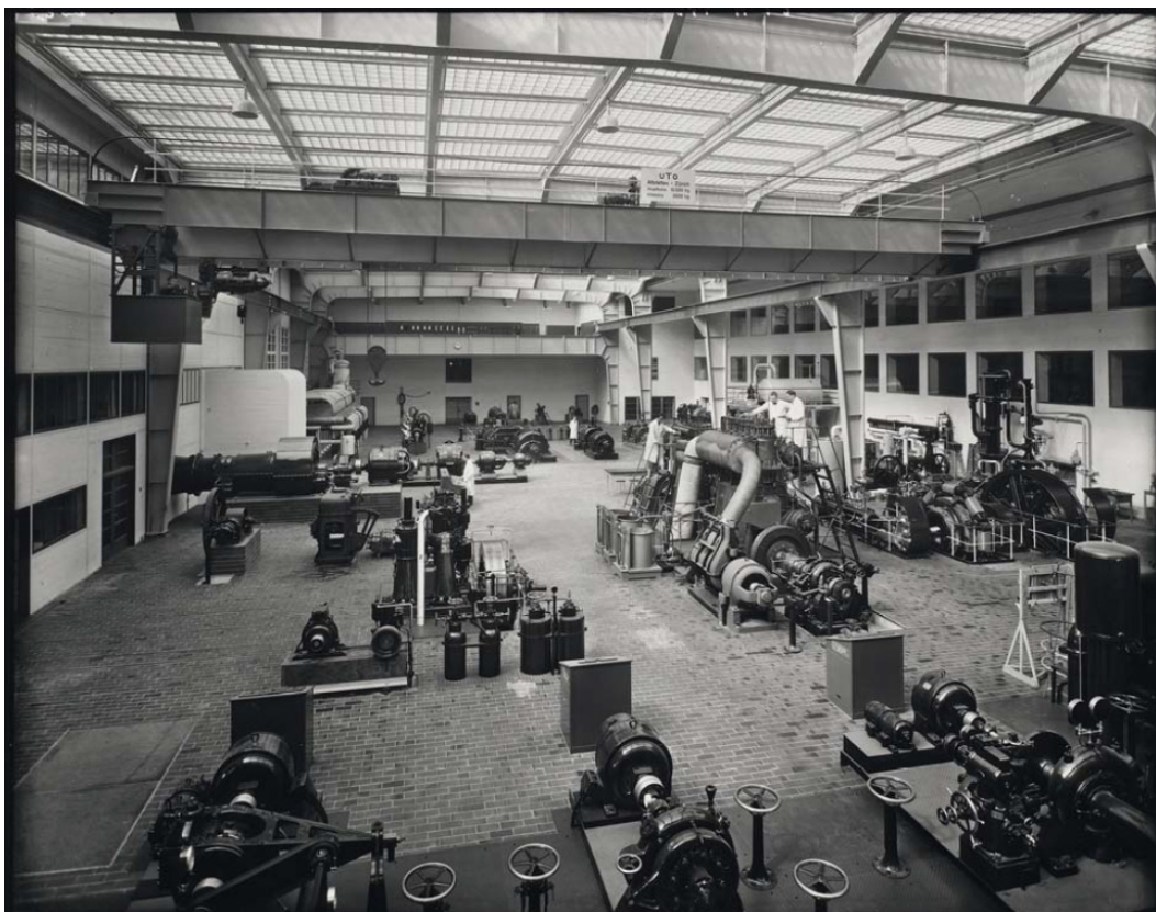
Abbildung 20: Maschinenhalle: Blick Richtung Leitwarte (ETH-Bibliothek)
