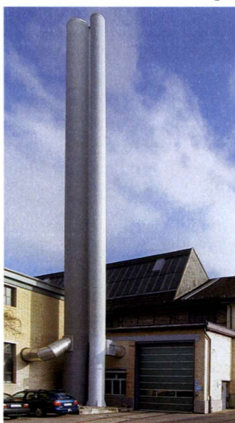
Beispiel einer neuen Kaminanlage Heizzentrale Sulzerareal Winterthur
