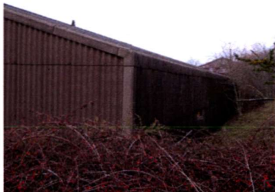
Asbesthaltige Fassaden- und Dacheindeckung
