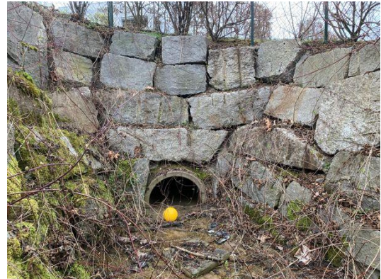
Ju_01: Auslauf Betonrohr, unten liegt Geschlebe (Schlamm)
