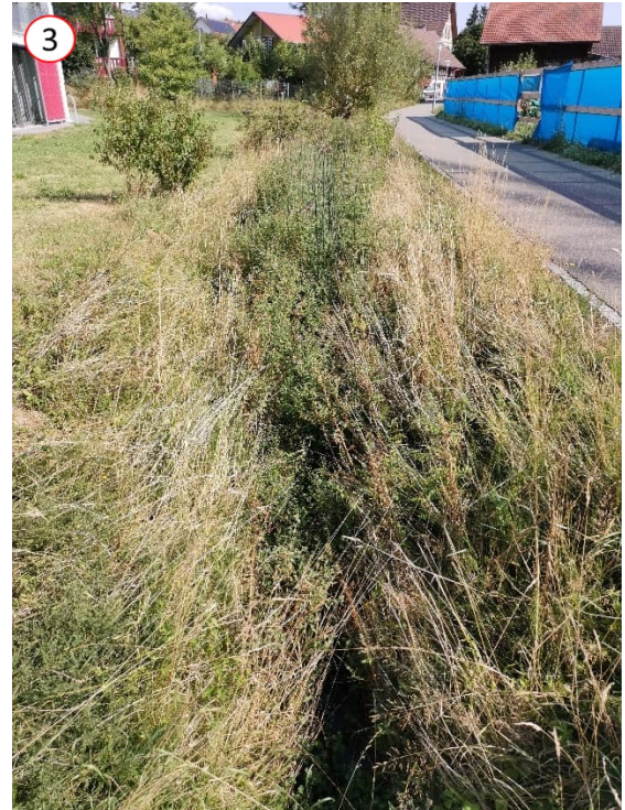
Abbildung 25: Verlauf Dorfbach entlang Weg "Am Bach", HWE befindet sich eingedolt rechts davon., 27.07.2022
