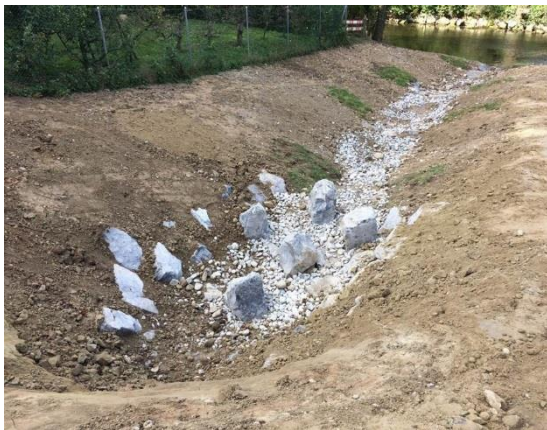
Abbildung 21: Beispiel eines Auslaufbauwerks mit Tosbecken und Störsteinen, während Bauphase (Blick in Fließrichtung. Quelle: HOLINGER AG)
