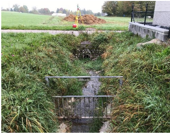
Abbildung 4: Stark beeinträchtigt Abschnitt vor das Einlaufbauwerk Fuchsweg (Blick in Fließrichtung)
