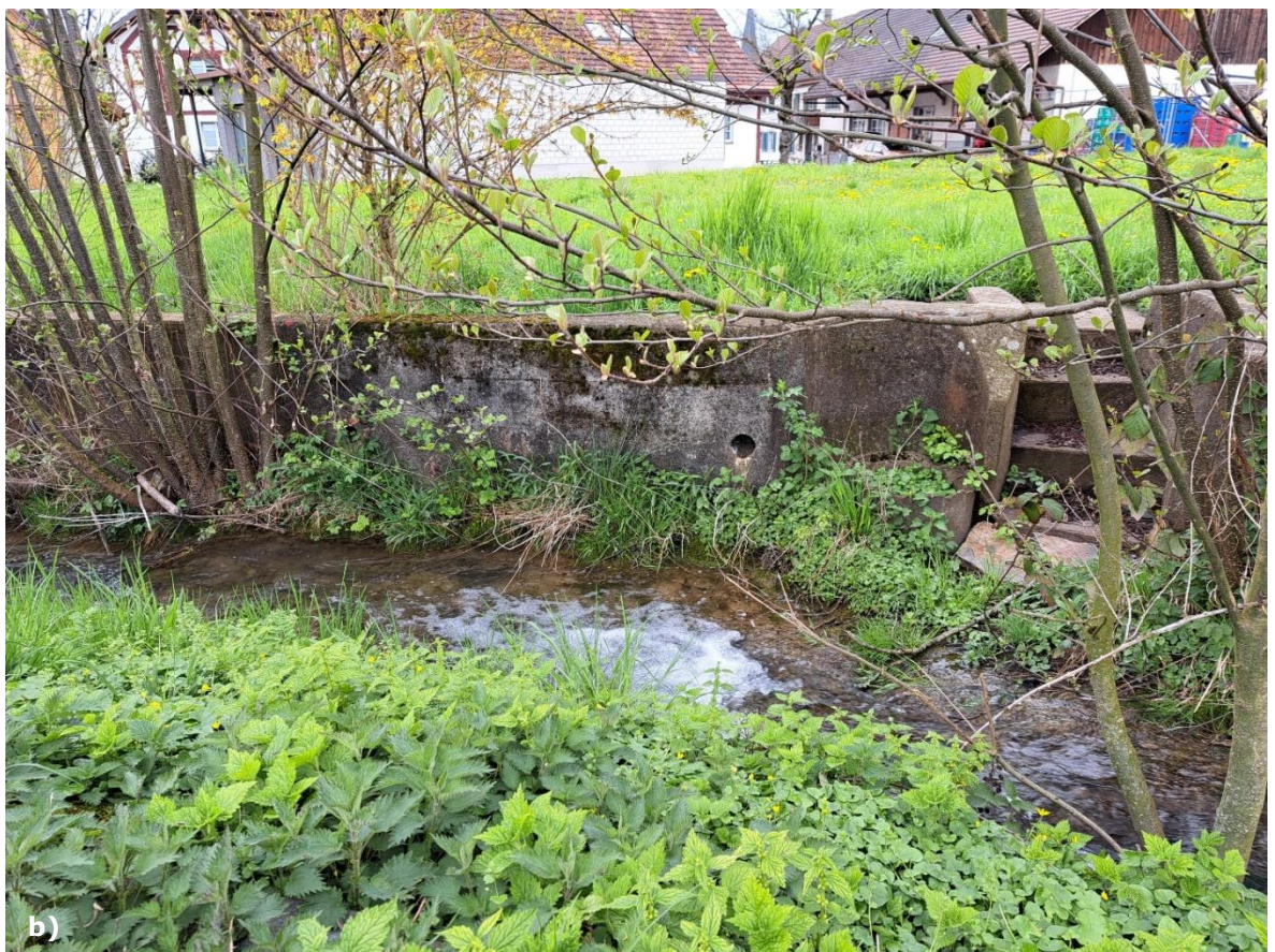
Abbildung 7 Abschnitt Dorfbach Parz 847/1838/1000 (NRP, April 2023). a) Blick gegen Fließrichtung auf Durchlass Parz. 847; b) Ufermauer Parz. 1838 (Fließrichtung von rechts nach links)
