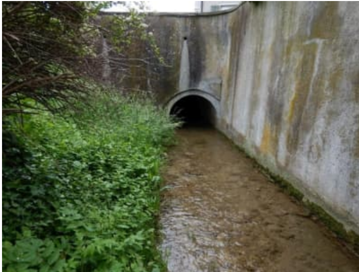
Abbildung 32: Abschnitt "Unterquerung Landstrasse" Nord (Gefahrenkartierung Naturgefahren, Technischer Bericht, 04.08.2017)
