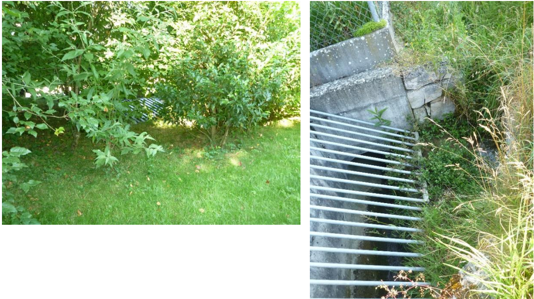
Abbildung 22: Einlauf (links) und Auslauf (rechts) des HWE Goldbach.
