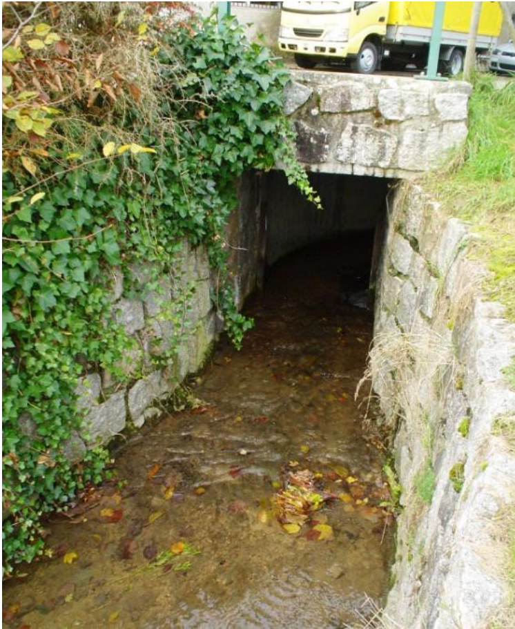
Abbildung 13: Einlauf Dorfbach in die Eindolung Rennweg. Bei HQ_{300} kann das Wasser mit 50 cm Überstau gerade noch abfliessen.
