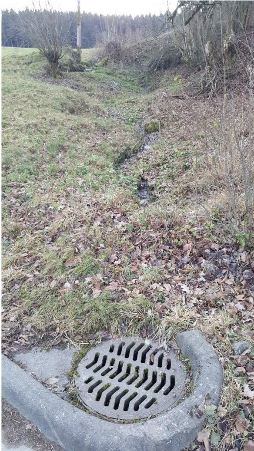
Abbildung 25: oberhalb Abschnitt "Strickbach", 15.01.2020
