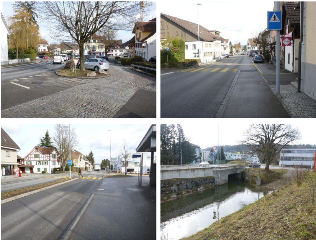
Abbildung 33: Eindolung Dorfbach – Abschnitt Zürichstrasse (oben links), Schwerzenbachstrasse (oben rechts und unten links), Auslauf unterhalb Kreisel (unten rechts, gegen Fließrichtung)
