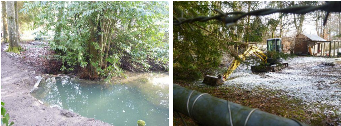
Abbildung 19: Eindolung Vordere Rüti – Einlauf (links) und eingedolter Abschnitt (rechts)
