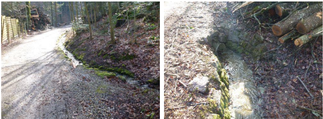
Abbildung 39: Schönau bach entlang Weg (links) und Durchlass unter dem Weg hindurch (rechts)
