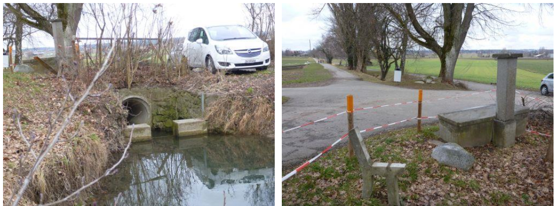
Abbildung 28: Durchlass Huebwisweg – Einlauf (links), eingedolter Abschnitt (rechts), Blick in Fließrichtung
