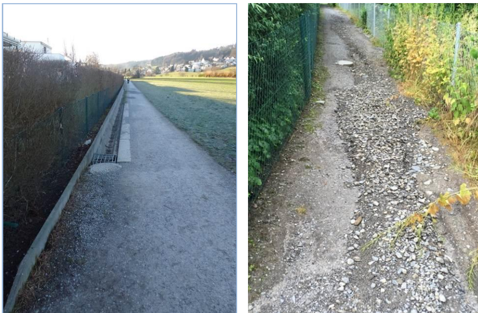
Bild links: Stellplatten und Ablaufrinne Breitiweg. Bei Starkregen ist dieses Fassungssystem überlastet. Ein Teil des Oberflächenabflusses fliesst dann über den Armenbachweg ab und führt dort zu Schäden (Bild rechts, 18.6.2015).
