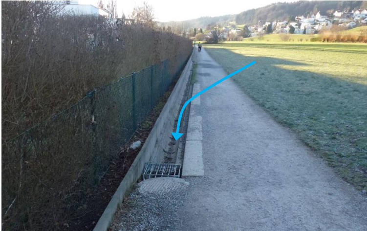
Rinne und Stellplatte längs des Breitwegs zum Schutz der Siedlung vor Oberflächenwasser aus den oberhalb (rechts im Bild) liegenden Wiesenflächen.
