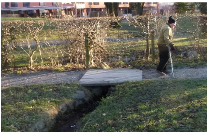
Steg Breitiweg mit ungenügender Kapazität.
