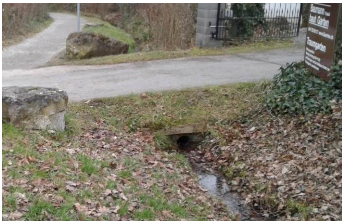
Durchlass bei der Zufahrt zu Parzelle 8121 s Baumann baut Gärten mit ungenügender Kapazität.
