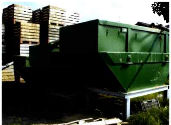
Abb. 5: Provisorium der Waschwasserbehandlung
